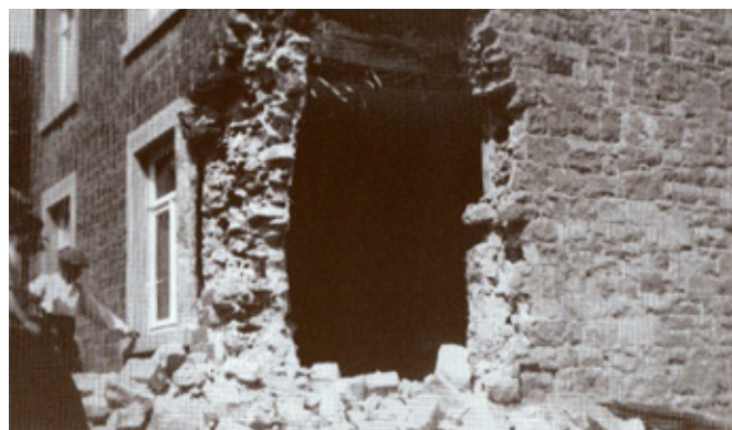
Maison Oscar Mossay partiellement démolie.
